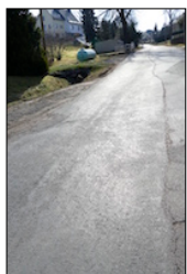
Abbildung 133: Zustand obere Straße
